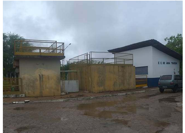
Foto 20 – Filtros e tanque de contato – ETA
