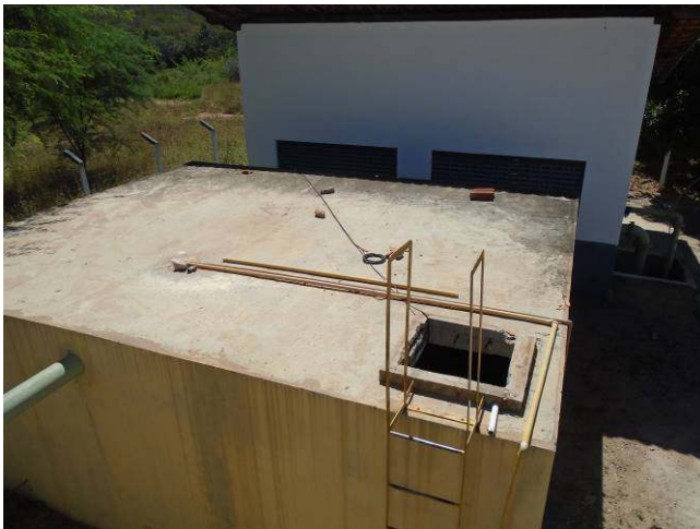
Foto 21 – Tanque de contato
